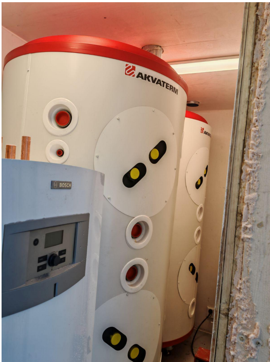
Lämminvesisäiliöt teknisessä tilassa 20.12.2024
