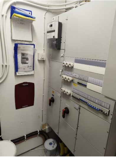
Sähkökeskus sijoitettuna varastoon 25.1.2025.
